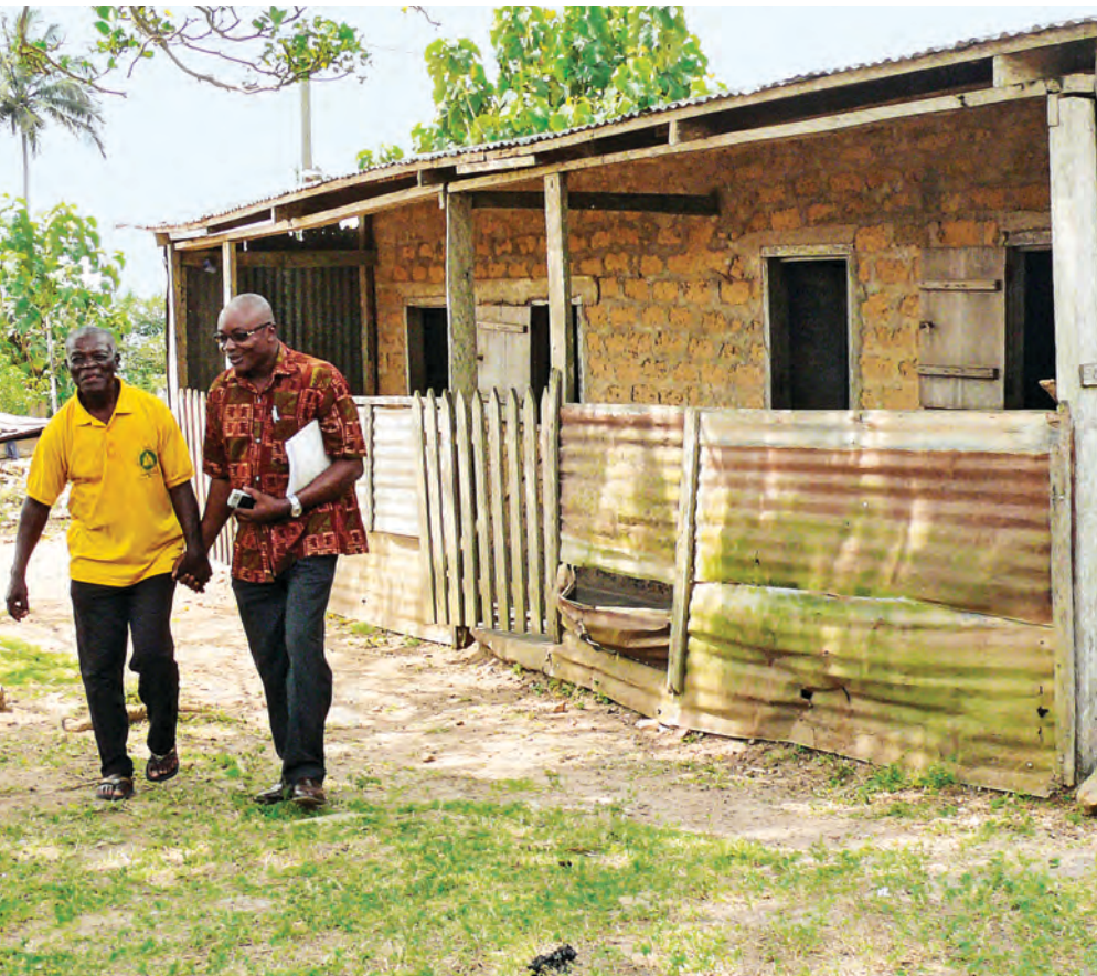
Das Gebäude des Kindergartens in Nyangbo Sroe ist baufällig und muss dringend ersetzt werden.
